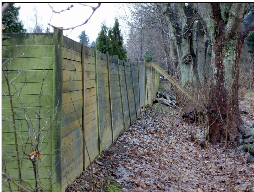
Figur 24. Støjskærme forventes normalt at have en levetid på ca. 30 år. Mange støjskærme etableret i begyndelsen af 1990'erne må forventes at have behov for vedligeholdelse eller udskiftning om få år. Denne skærm havde nedgravede træstolper, der var rådne efter ca. 10 år. Skærmen blev udskiftet i et støjpartnerskabsprojekt finansieret af grundejerne, Allerød Kommune og Miljøstyrelsen.
